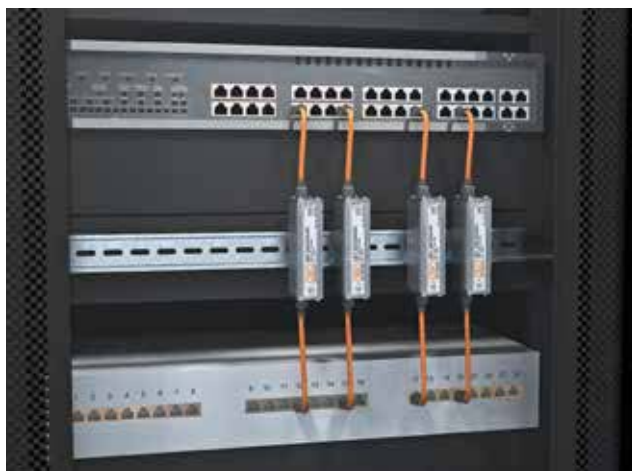
Рис. 3.81 Рекомендация по защите на коммутаторе с коммутационной панелью. УЗИП заземлены через U-образную шину.
