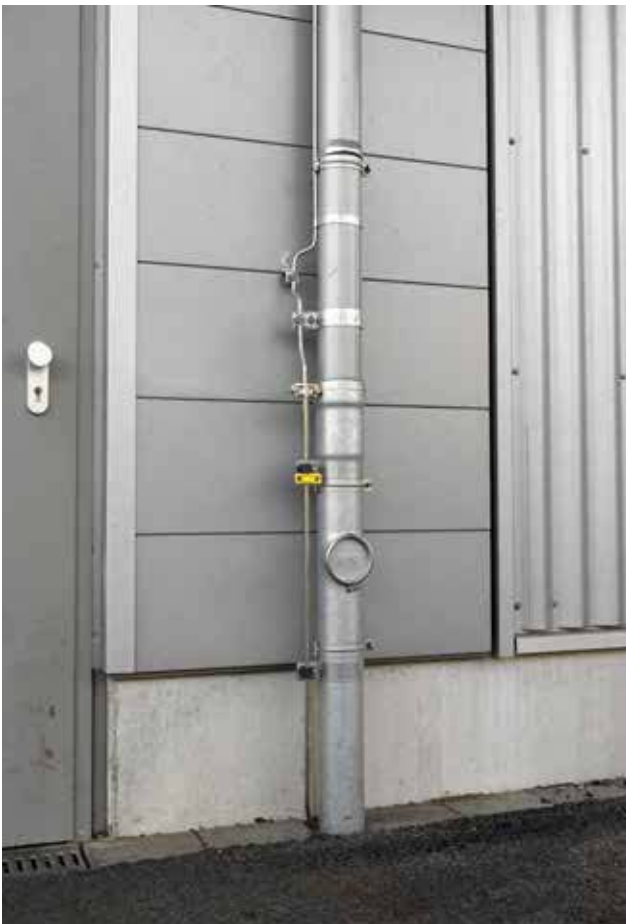
Рис. 2.18: Токоотвод молниезащиты на водосточном стояке
