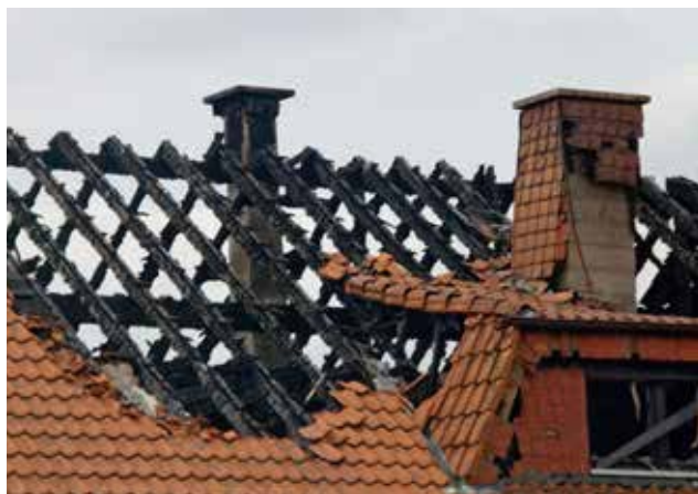
Рис. 1.19: Повреждения здания от прямого удара молнии
