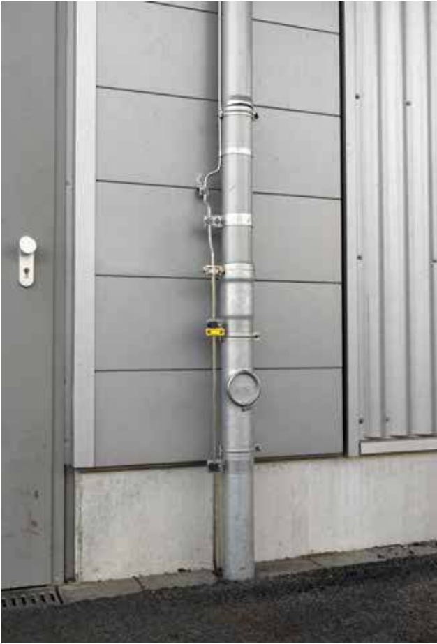
Рис. 2.18: Токоотвод молниезащиты на водосточном стояке
