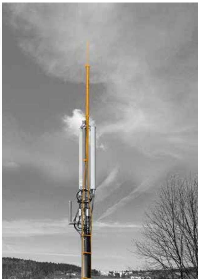
Рис. 2.72: Мачта мобильной радиосвязи с проводом isCon®
