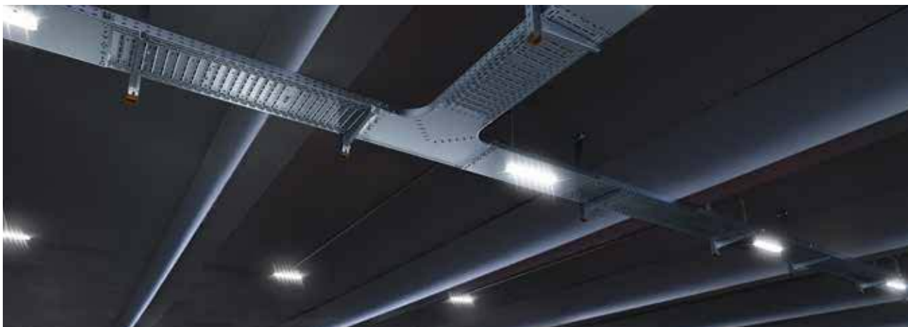
Рис. 3.29: Светодиодная система освещения крытой автостоянки
