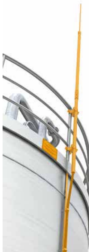
Рис. 2.27: Молниеприемная мачта с расположенным внутри проводом isCon®
